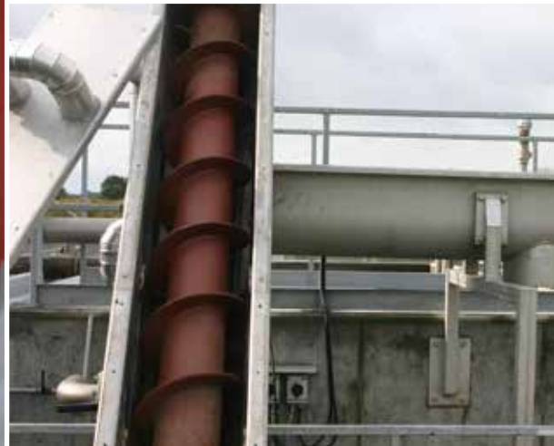
Sneglearrangement til sandfang på rensningsanlæg
